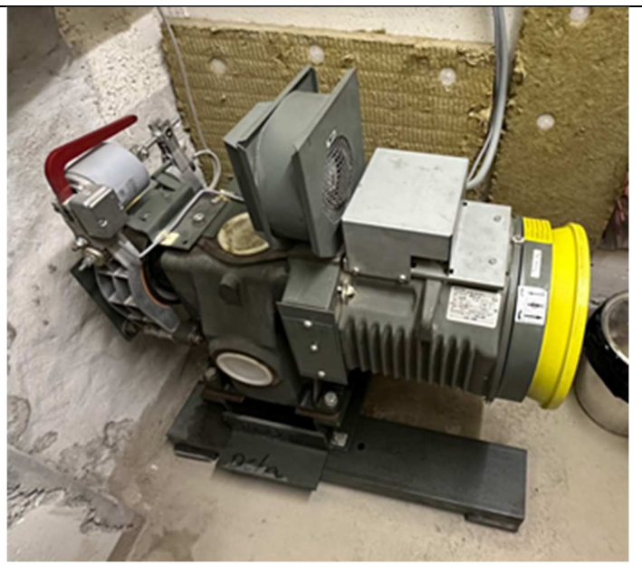
Die Antriebseinheit ist normal abgenutzt. In ca. 3-5 Jahren müssen die Tragseile sowie die Treibscheibe ersetzt werden.
